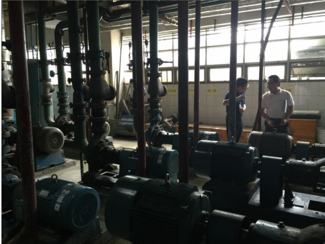
核查人员现场核查莱宝高科技股份公司电机改造情况
