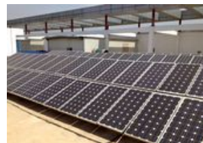
江西南昌华南城地下车库 PV-LED 太阳能照明工程
