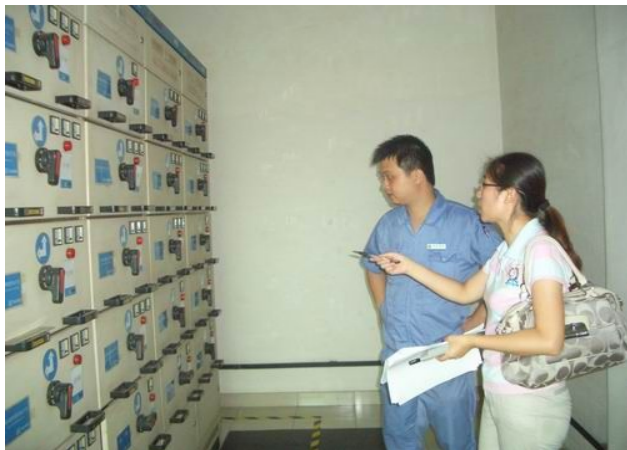
查看龙岗区妇幼保健院配电房
