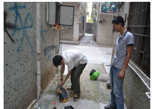
新南社区富安东西小区配电箱电能测量
