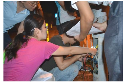
深圳市节能专家联合会工作人员 在现场测量路灯用电情况
