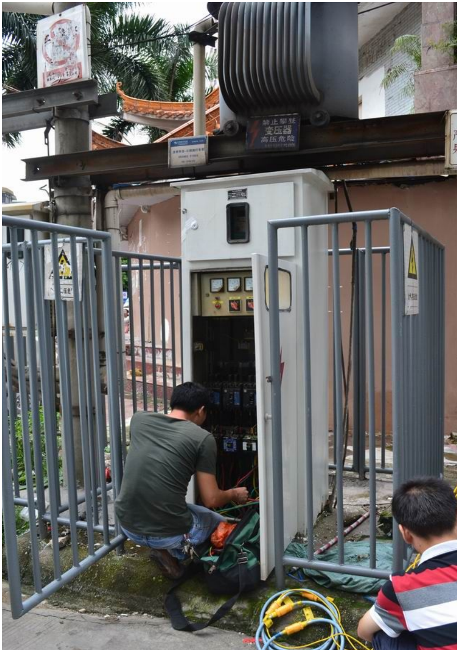
深圳市节能专家联合会工作人员测量路灯变压器工作情况
