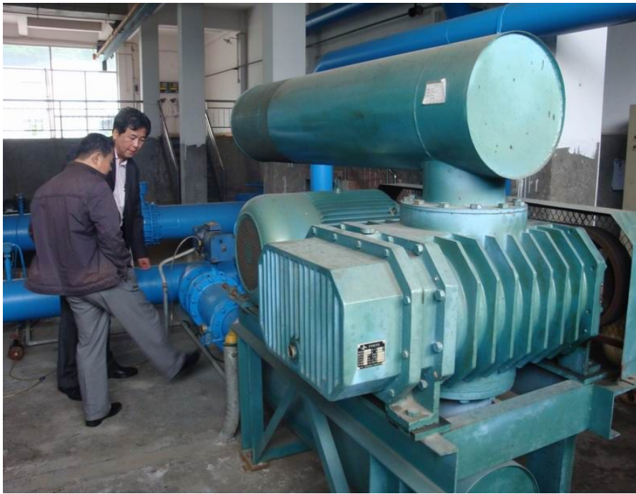
现场查看电机运行情况
