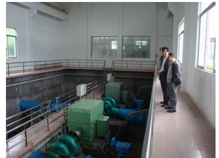
现场查看电机运行情况
