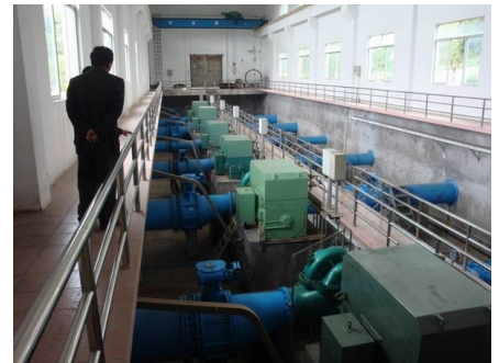
现场查看电机运行情况
